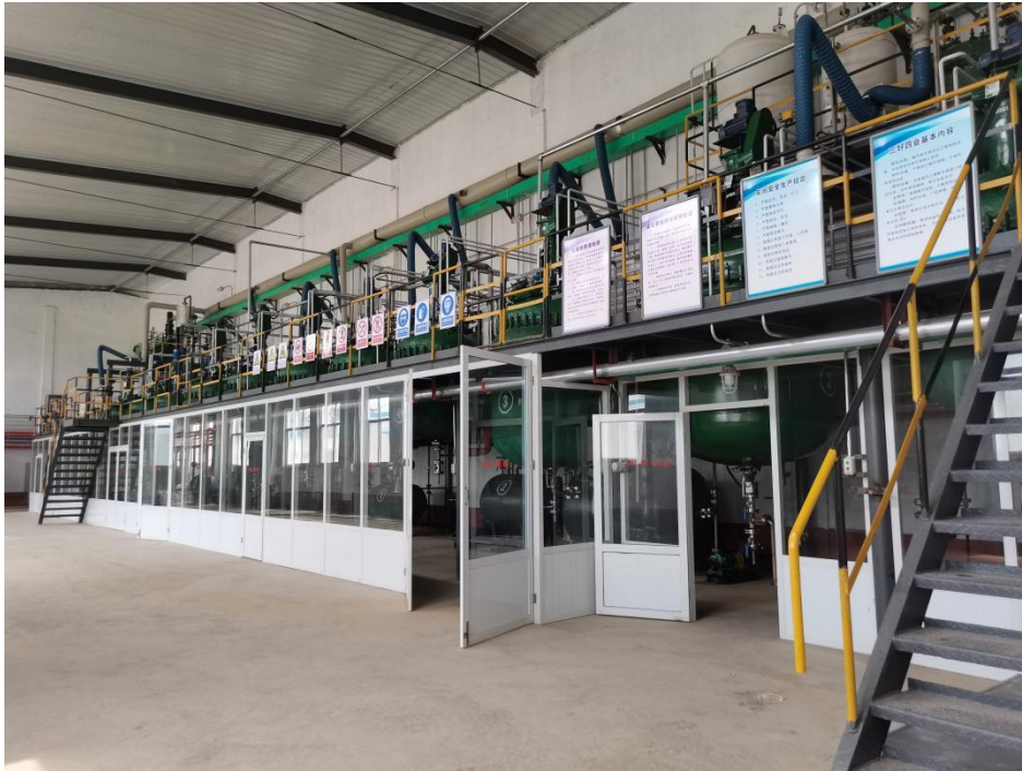
车间密闭减少无组织废气排放
