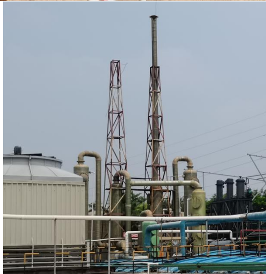
DA002 排气筒处理设施及排气筒照片(污水站废气处理设施)
