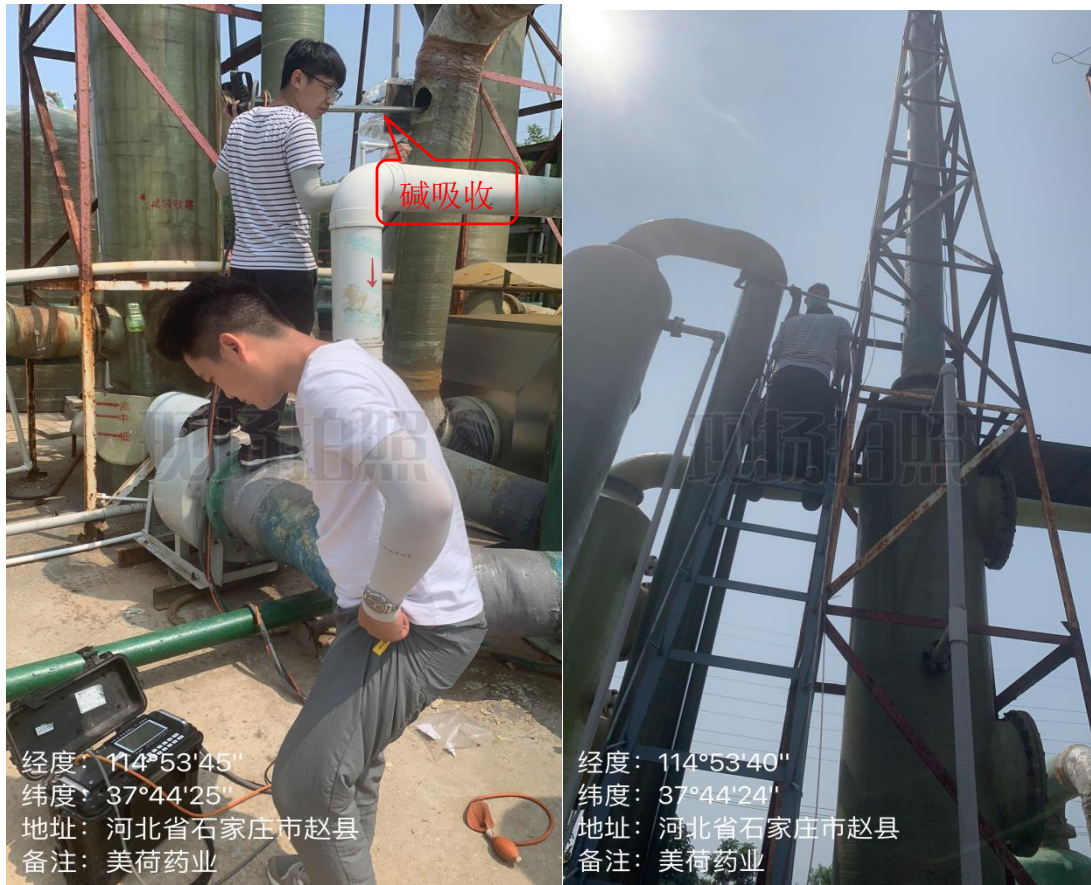
DA002 碱吸收装置及检测照片（污水站废气处理设施）
