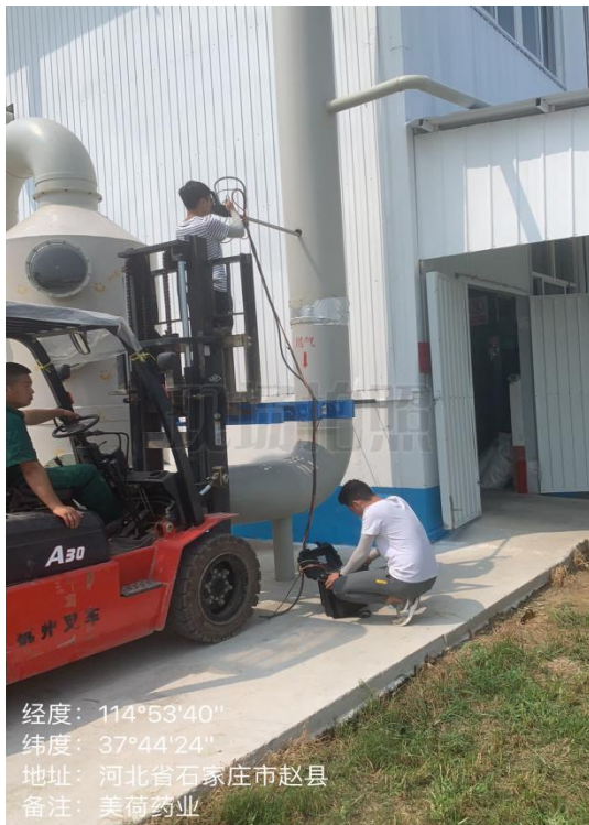
DA001 处理设施进口检测
