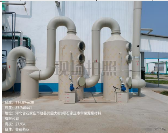
二级冷凝+二级碱吸收+除雾塔装置
