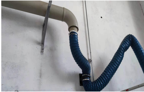
伊维车间尾气回收加装除尘袋
