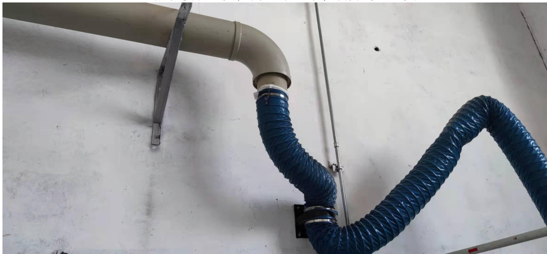
伊维车间尾气回收加装除尘袋
