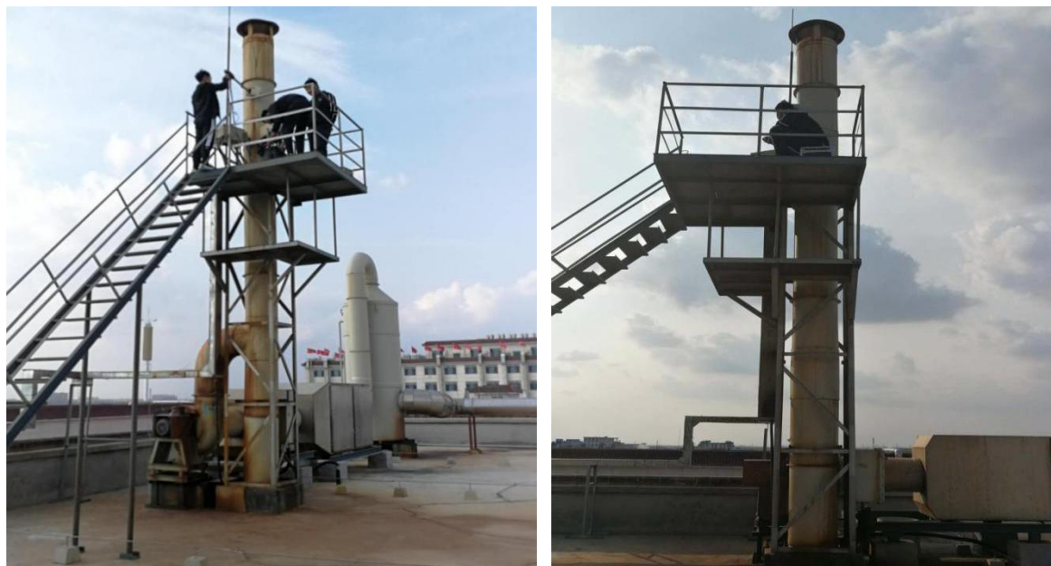
图4-1 生产车间废气处理设施
