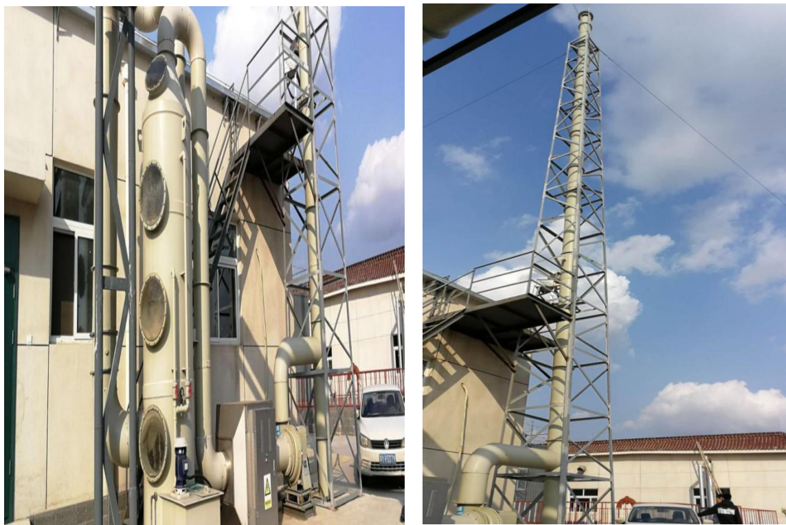
图4-2 危废间、污水处理站废气处理设施
