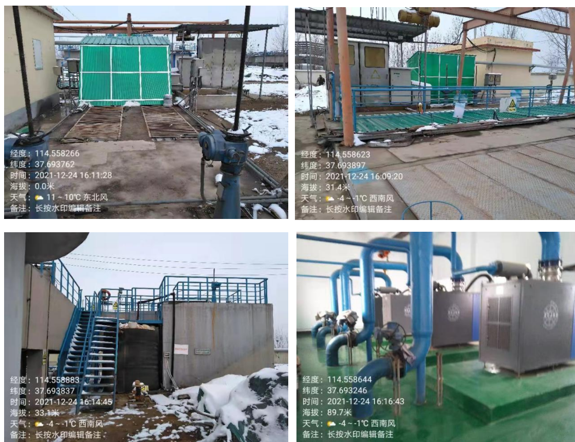
图 4-2 污水处理设施
