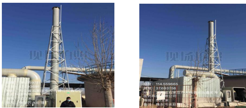
图 4-1 生物除臭塔+15 米排气筒
